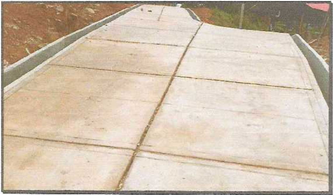
TOMA 1: VISTA DE LOS TRABAJOS DE VACEO DE VEREDA CONCRETO F'C-175 KG/CM2, INC. UÑAS.
