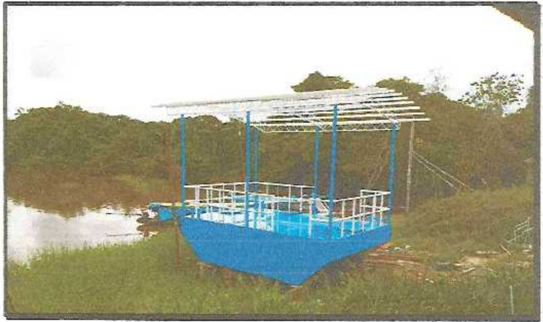
TOMA 9: VISTA DE LOS TRABAJOS DE CONSTRUCCION DE PONTON CON ESTRUCTURAS METALICAS (SEGUN DISEÑO)
